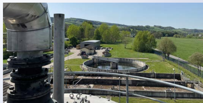
Bild: Blick vom Faulturm der Kläranlage Olbernhau auf das Belebungs- und Nachklärbecken. Foto: Stadtwerke Olbernhau GmbH
